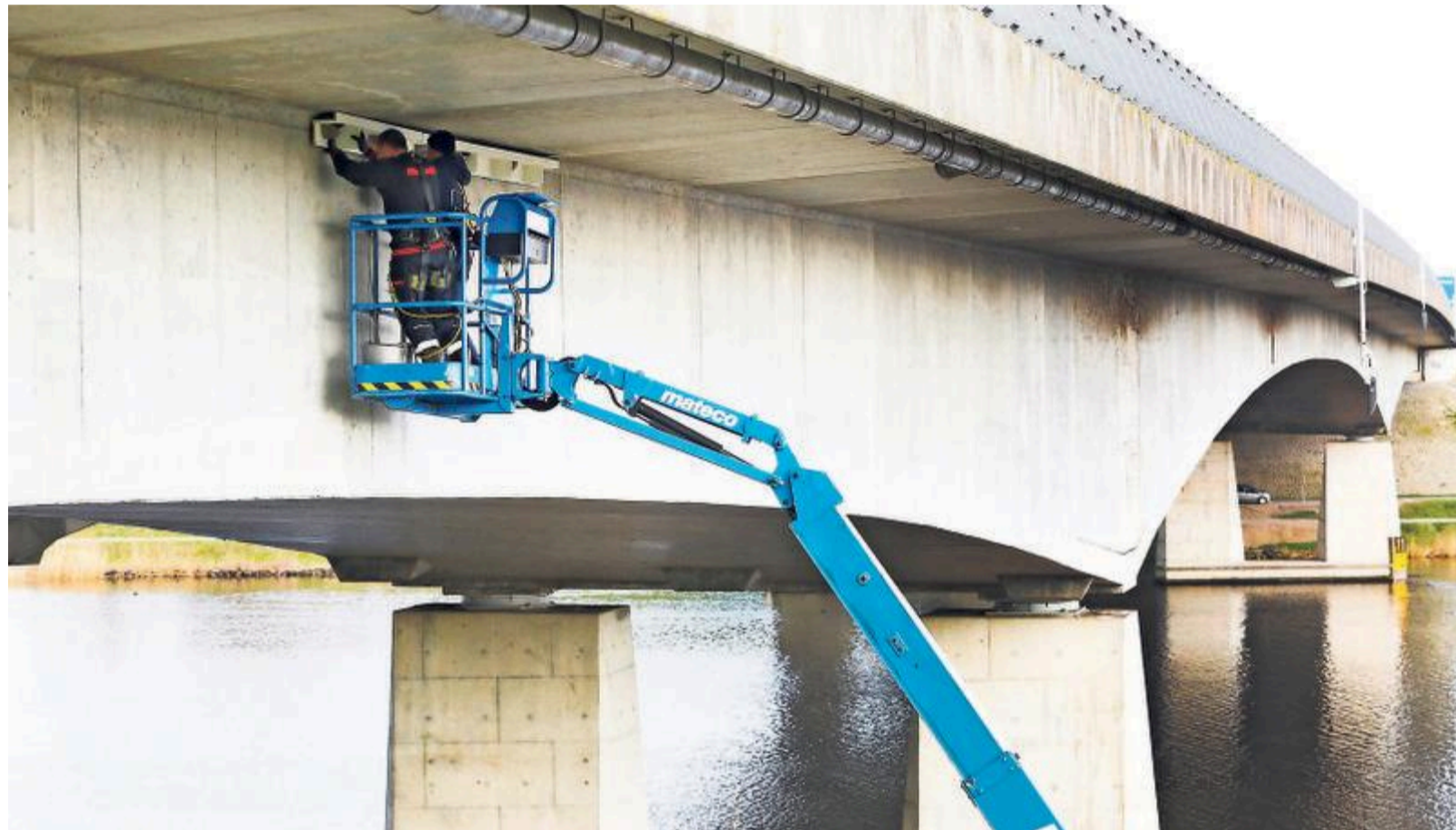
Met een hoogwerker worden de zwaluwnesten geplaatst aan de onderzijde van de Stichtse Brug.
